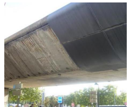
Corrosion des aciers extérieurs des bracons et filets de protection
